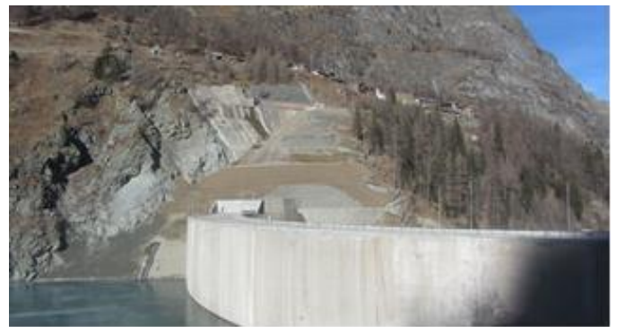
Figure 15. Works for naturalization of the right (up) and left (down) banks / Lavori di rinaturalizzazione della sponda destra (in alto) e sinistra (in basso).
