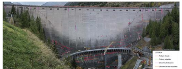
Figure 5. View of the main cracks on the downstream face of the dams / Vista delle principali fessure sul paramento di valle della diga.
